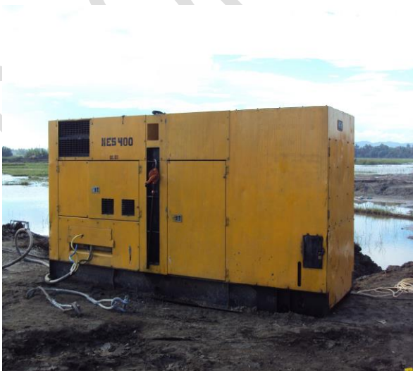
Genset NES 400/400 KVA, in IKPP/PERAWANG/RIAU.
